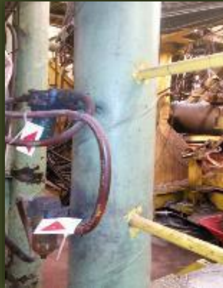
Fig 6. Fuga de aire "63"
