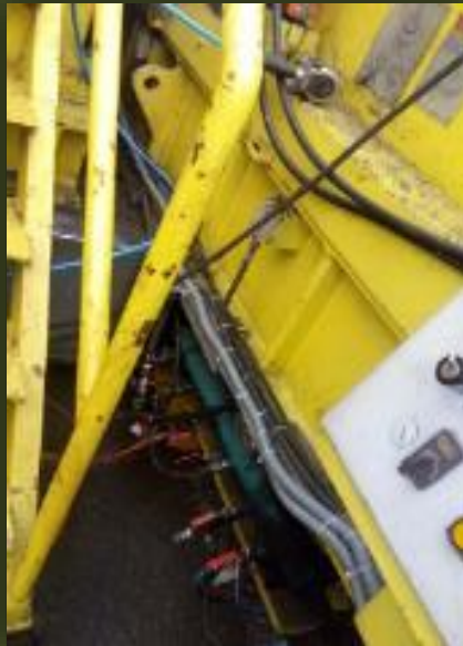
Fig 5. Fugas de aire 61" y 62"
