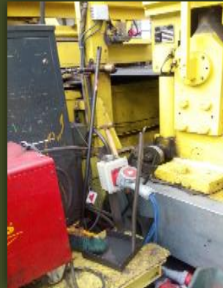
Fig 8. Fugas de aire "65" y "66"
